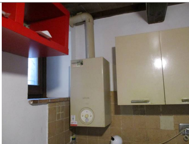
Foto n. 8 - Particolare caldaia - P.T.
