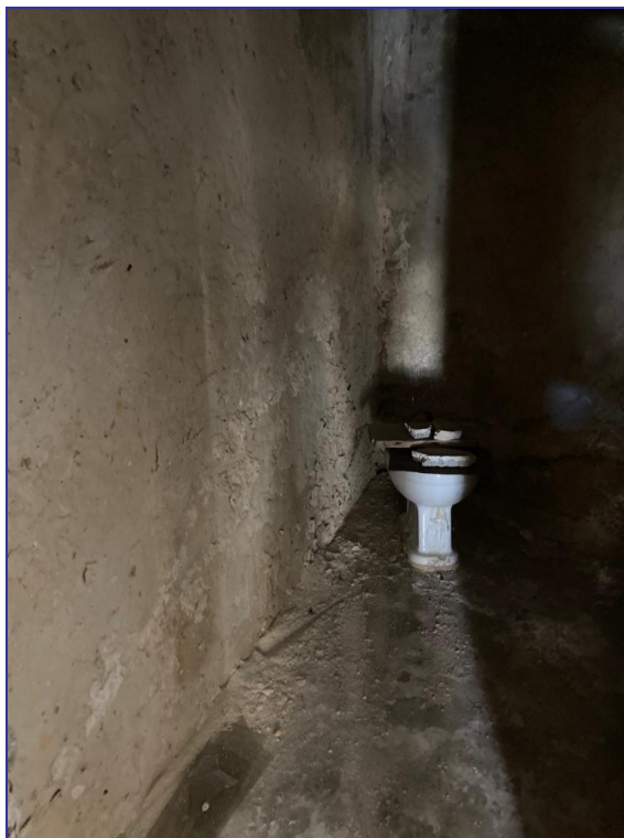
Foto 20 – Imm. 3 – Servizio esistente del locale commerciale con aerazione mediante finestra.
