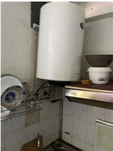
boiler ACS (caldaia per riscaldamento assente)
