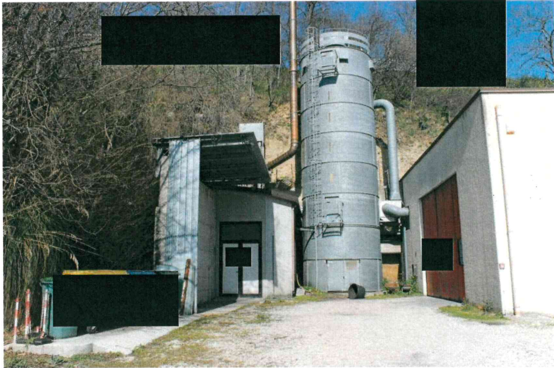
FOTO 5: Silos impianto di aspirazione con locale tecnico
