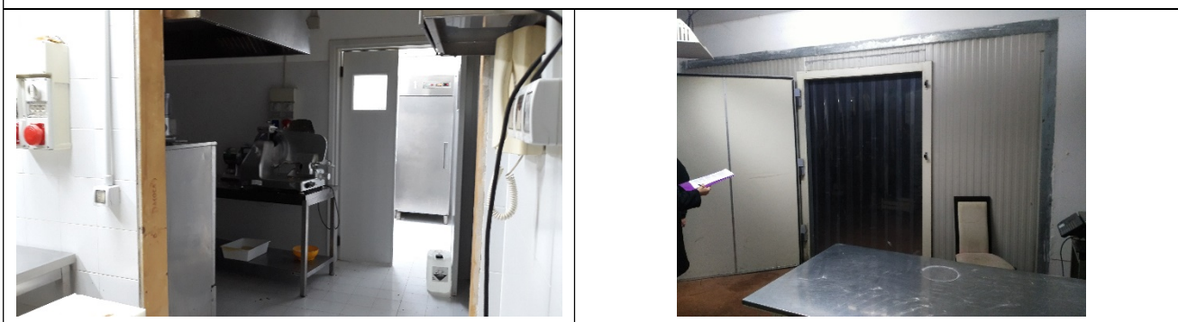
Foto 7-8 | Locali cucina industriale e ingresso cella frigorifera
