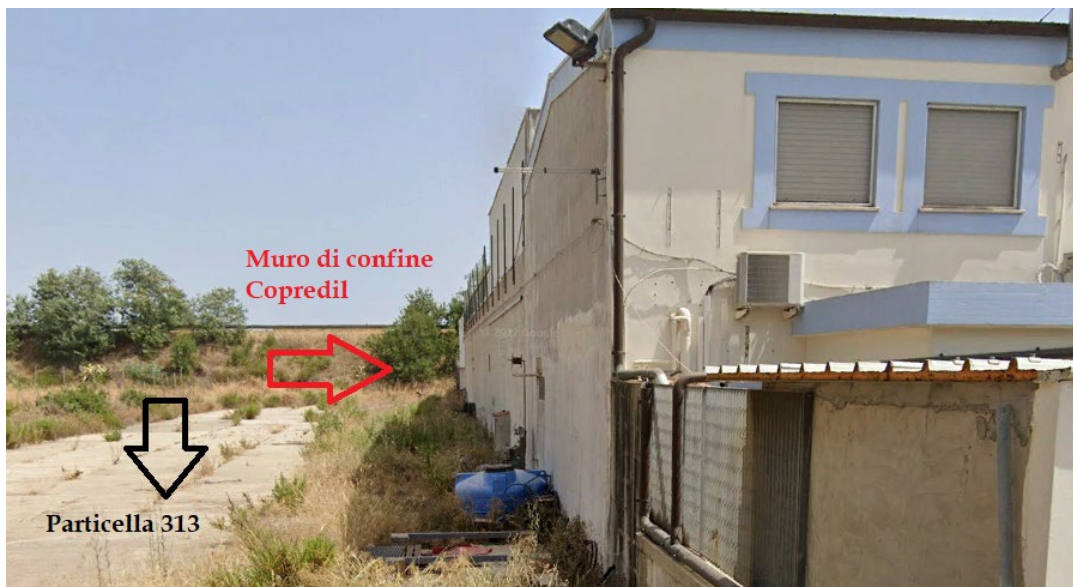
Vista da Google Street View del muro di confine/parete in oggetto dalla part.313: muratura preesistente.
