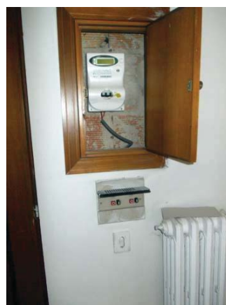
20 | particolare quadro elettrico
