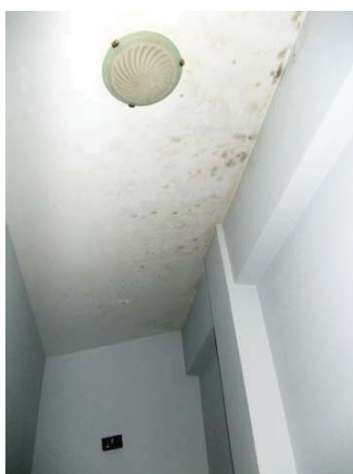
30 | disimpegno: danni da infiltrazioni acque meteoriche
