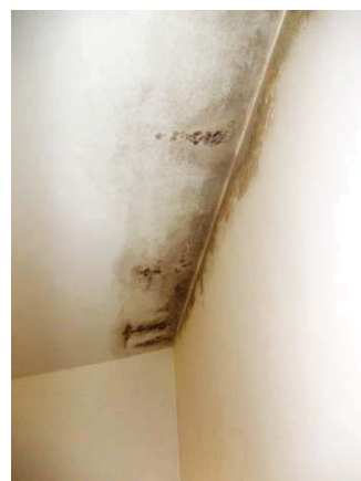
17 | c. letto: danni da infiltrazioni acque meteoriche
