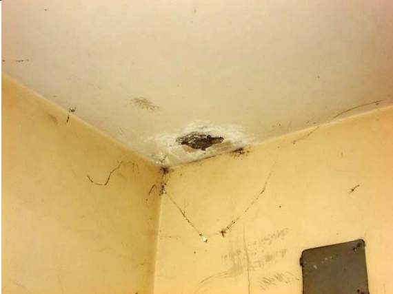
8 | particolare danni infiltrazione solaio copertura pianerottolo
