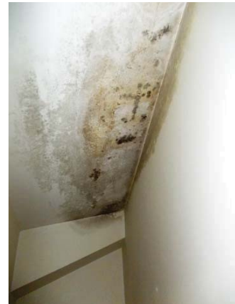
13 | disimpegno: danni da infiltrazioni acque meteoriche
