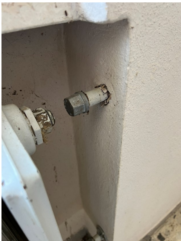
Particolare di uno dei radiatori interni all'unità immobiliare che sono stati tutti staccati dalle tubazioni in multistrato collegate all'impianto centralizzato condominiale.
