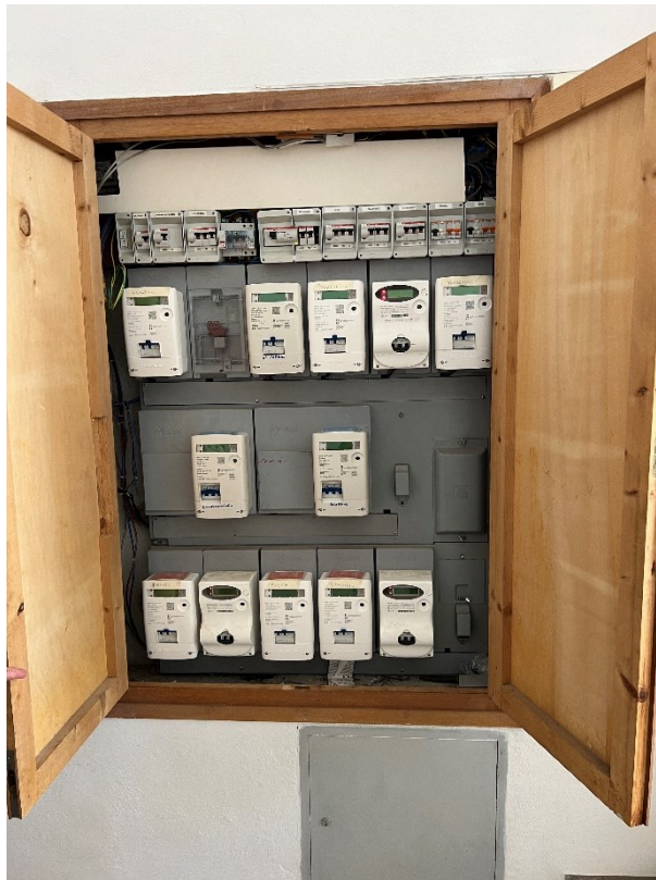
Assenza del contatore dell'energia elettrica nel vano comune nell'androne comune al piano terra
