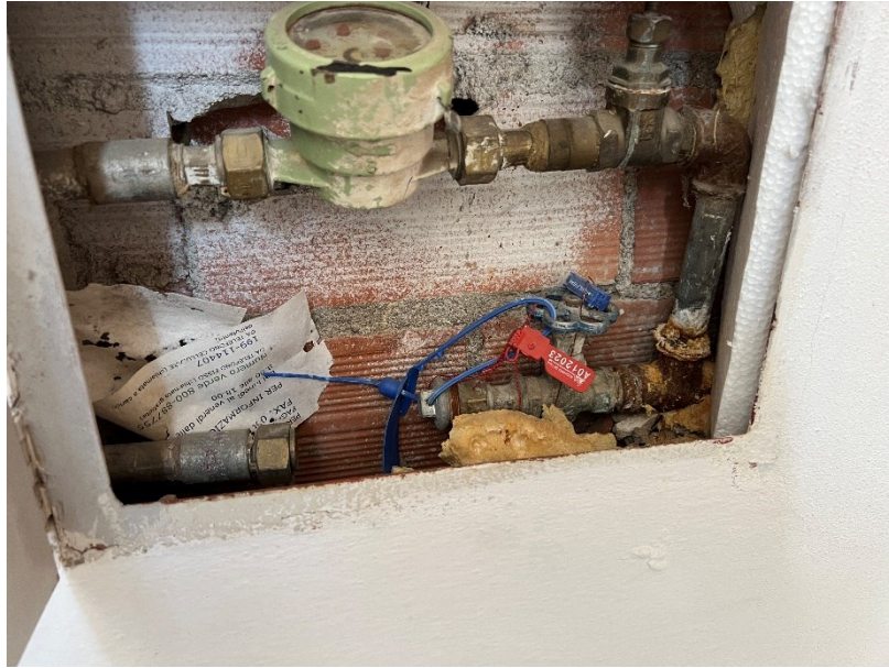
Assenza del contatore dell'acqua nel vano comune sul pianerottolo del piano terzo
