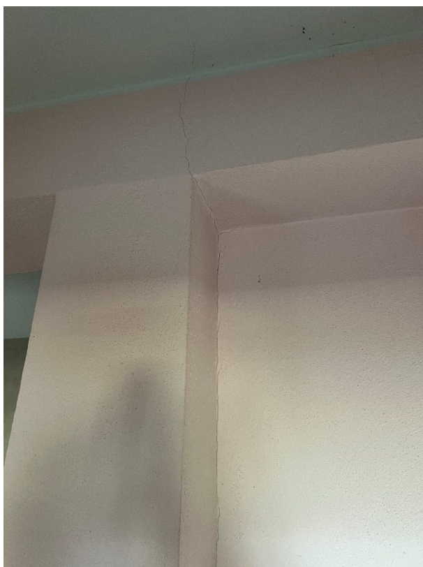
Particolare delle lievi lesioni all'interno dell'appartamento
