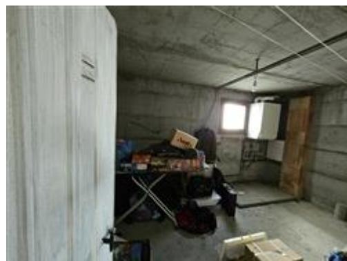
centrale termica piano terra
