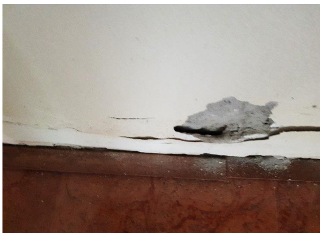
Distacco degli intonaci alla base della muratura
