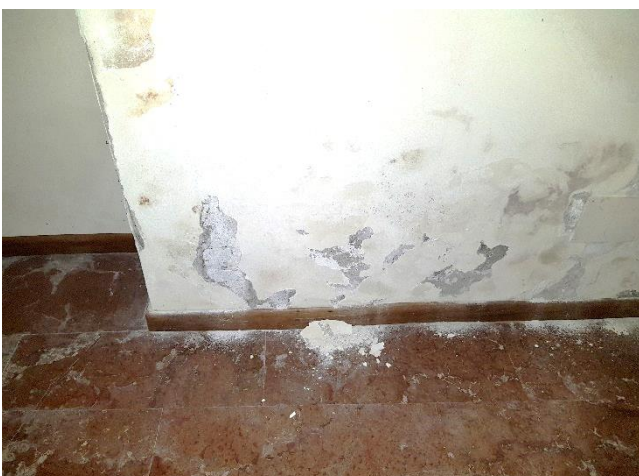
Distacco degli intonaci alla base della muratura
