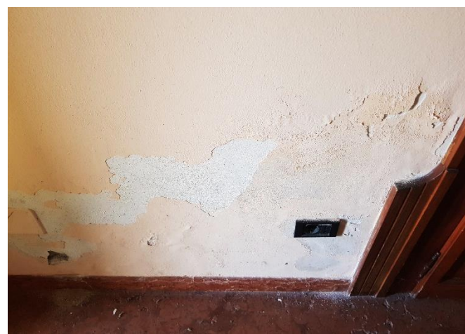
Distacco degli intonaci alla base della muratura
