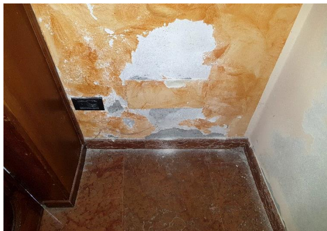
Distacco degli intonaci alla base della muratura
