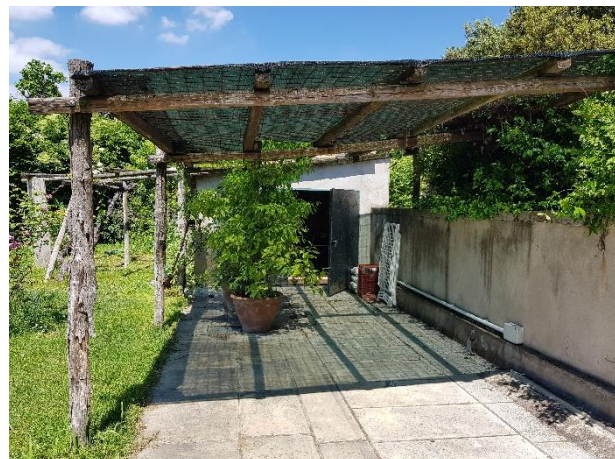
Vista della tettoia e deposito esterno non conformi
