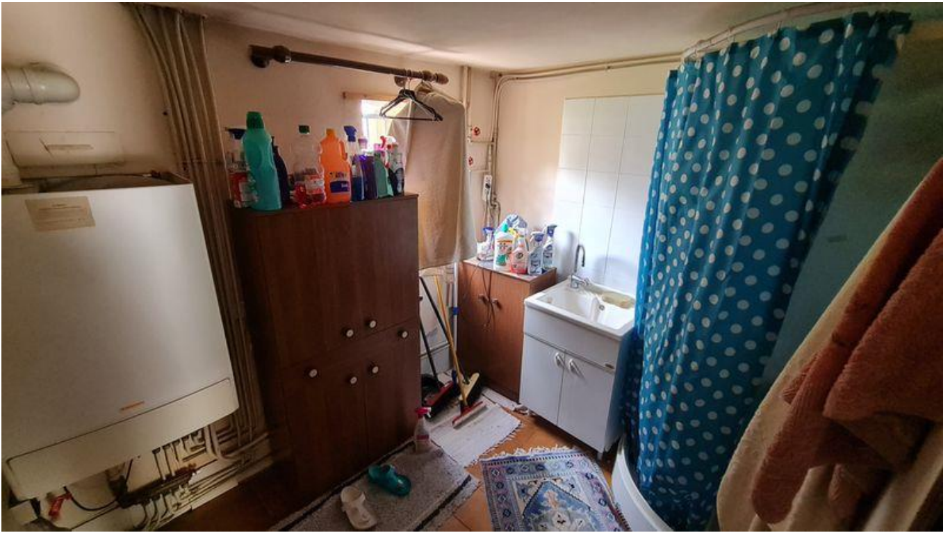
Centrale termica. (PT)
