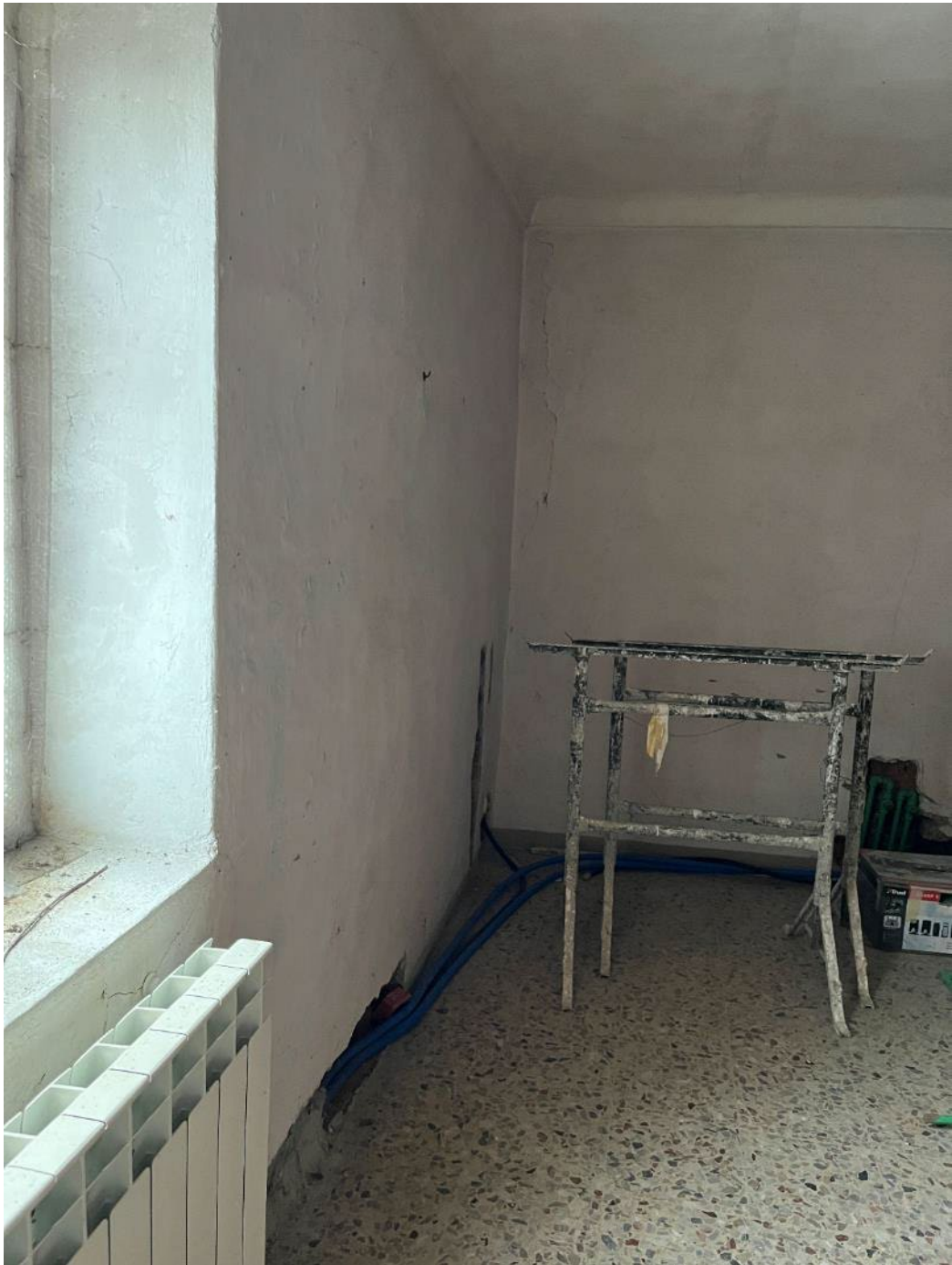
Figura 31: vista del bagno al piano primo del bene 1, si noti come i lavori non siano terminati
