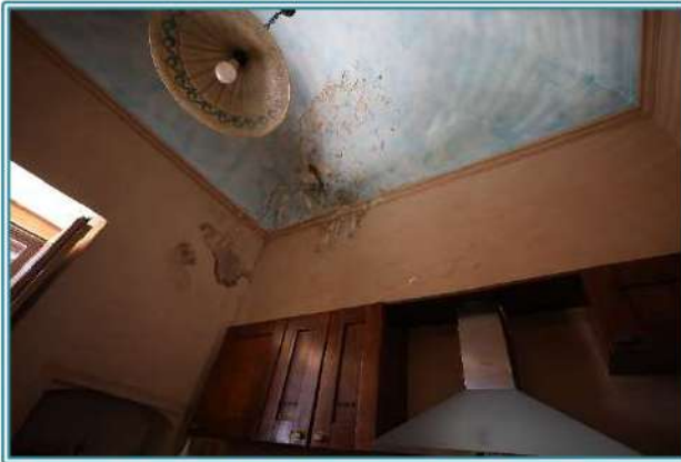
Figura 16 Dettaglio infiltrazione sul soffitto della cucina
