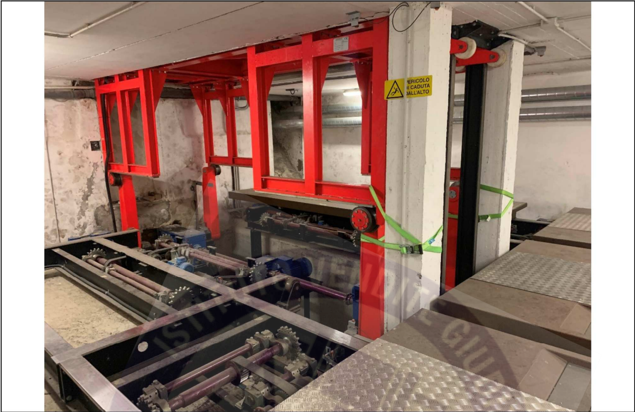
Foto Lotti 1-2-3- Posti auto autorimessa collettiva posta al piano interrato con piattaforma elevatrice meccanizzata al piano terra- proprietà indivisa
