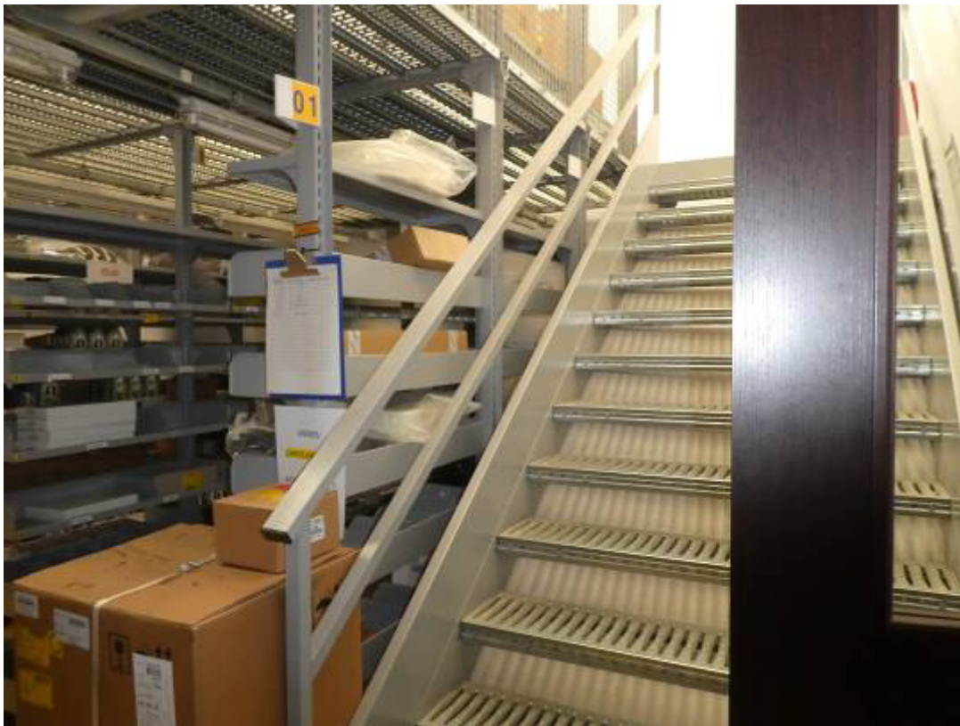
-12- scala di accesso al soppalco abusivo
