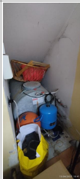
Foto 28 Vista della riserva d'acqua nel vano costruito all'interno del box
