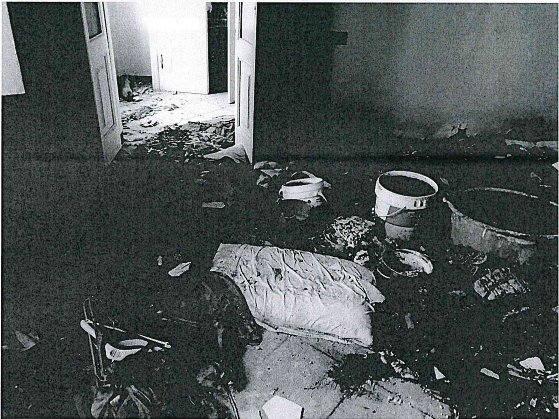
Vista particolare zona colpita dal crollo parziale del sovrastante solaio
