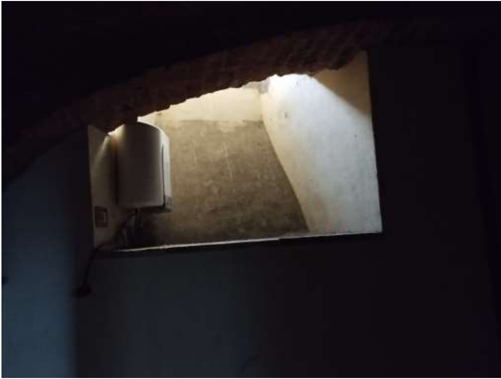
BOILER ELETTRICO NEL BAGNO
