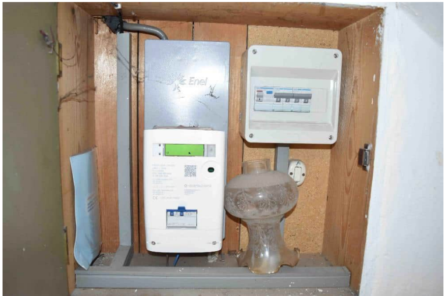
PT, quadro elettrico.
