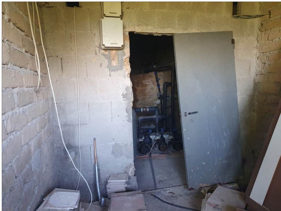
Foto 54 – ingresso locale tecnico piscina
