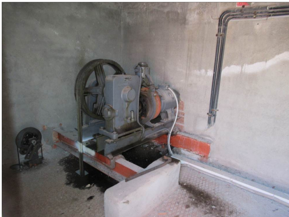
Foto 52 – locale tecnico ascensore
