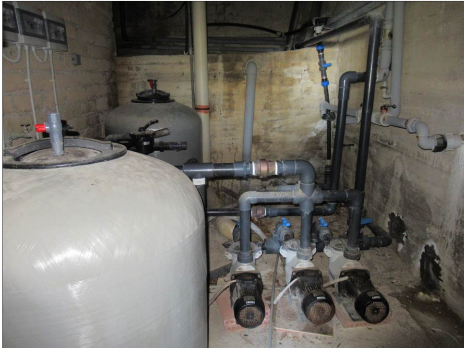
Foto 55 – locale tecnico piscina
