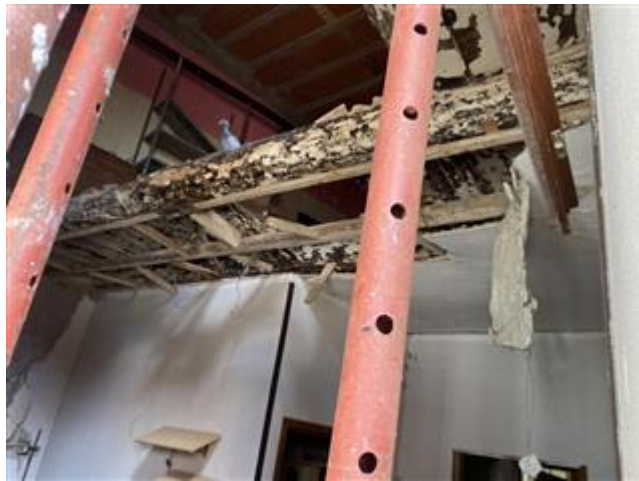
Fotografia dell'interno dell'U.I. dichiarata inagibile
