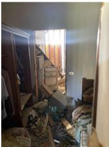
Fotografia dell'interno dell'U.I. dichiarata inagibile
