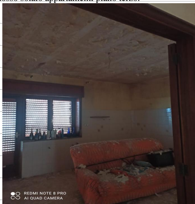
Foto 3 Intradosso solaio appartamenti piano terzo.
