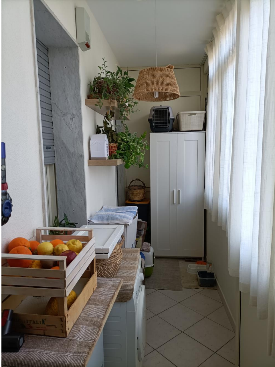
Foto 13. Vista del balcone a nord-est chiuso con struttura precaria in alluminio e vetro.
