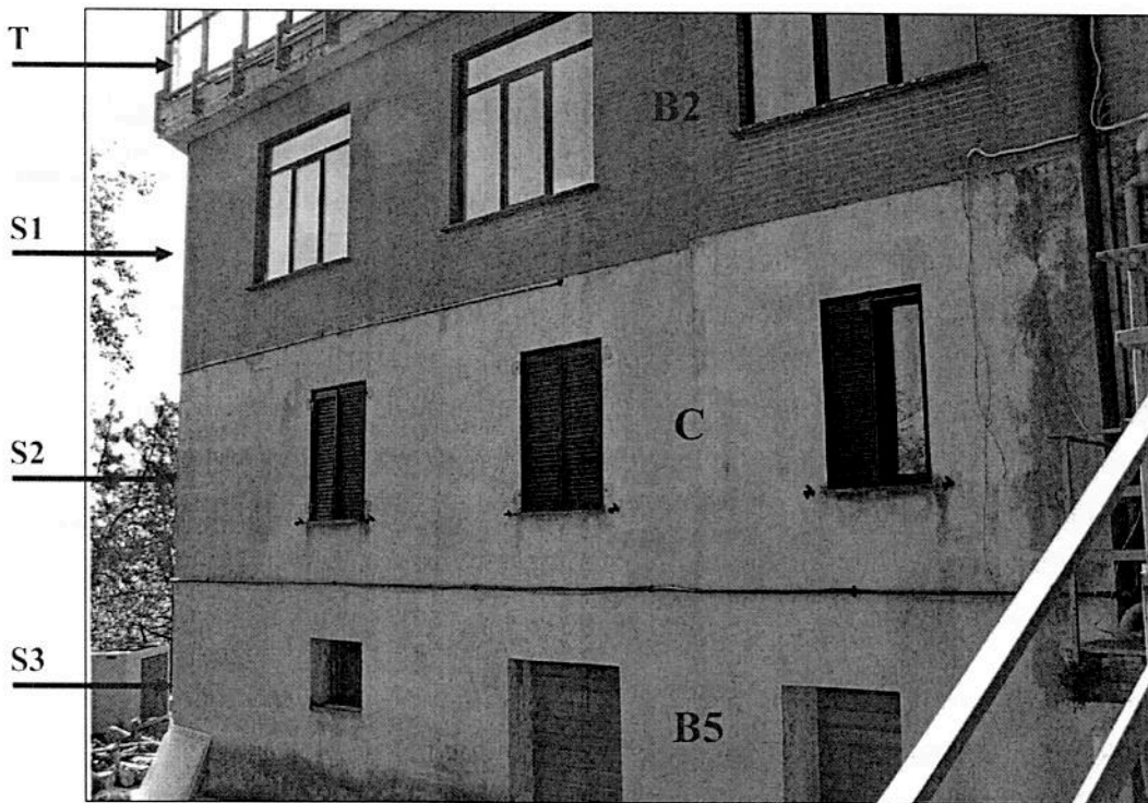
Foto 27: facciata Nord Est, in basso beni B5 con accesso dall' esterno (corte)
