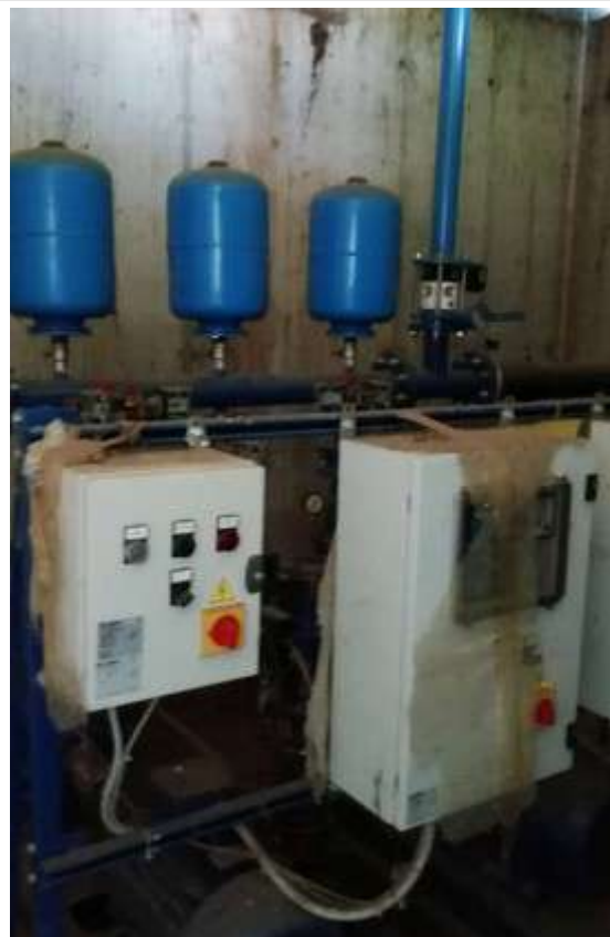
Centralina impianto antincendio
