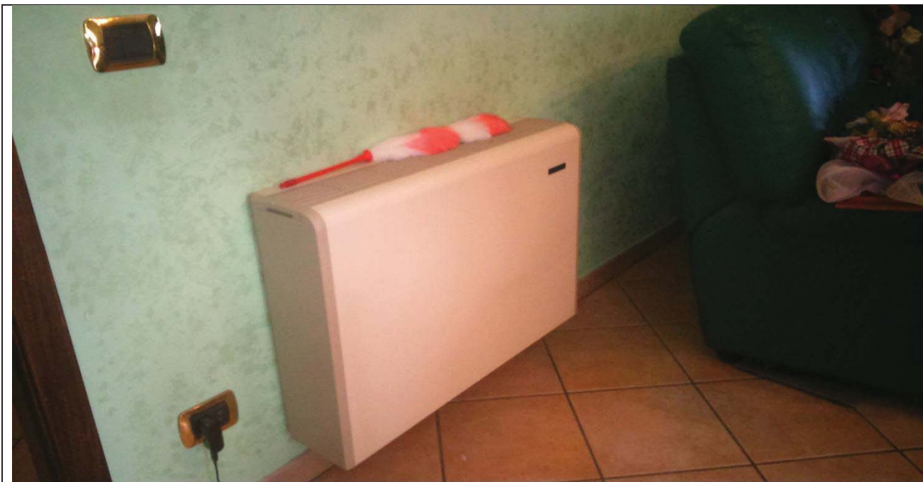
Sistema di riscaldamento
