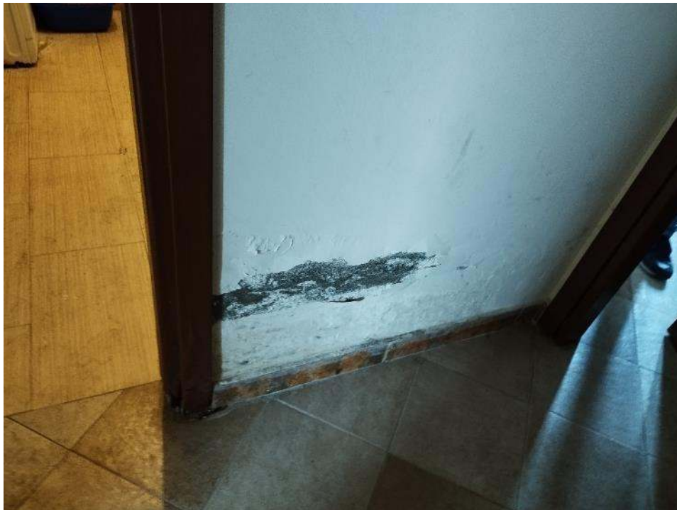
Figura 24: infiltrazioni d'acqua in corrispondenza con il piatto doccia.
