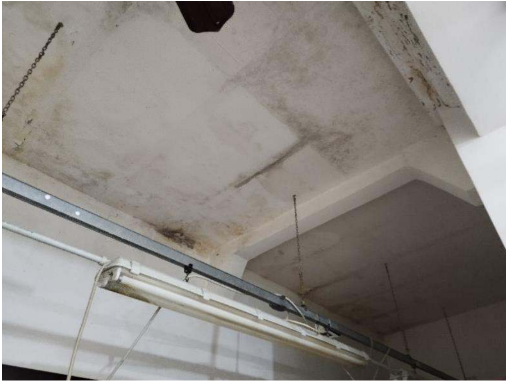
Figura 29: soffitto cantina con infiltrazioni d'acqua provenienti dal balcone.
