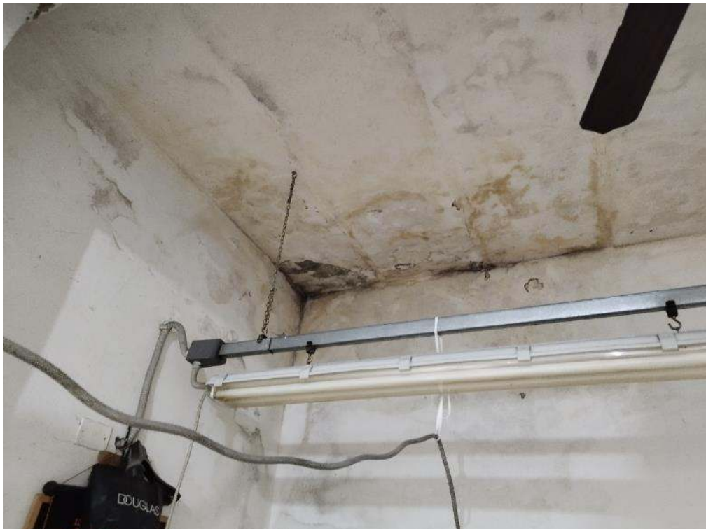
Figura 28: soffitto cantina con infiltrazioni d'acqua provenienti dal balcone.
