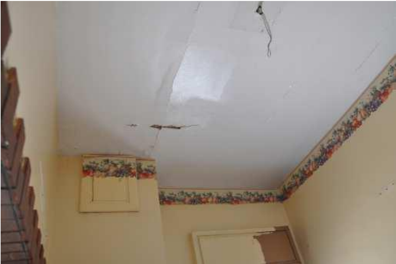
Foto 33 - Vano Cucina - Degrado del soffitto
