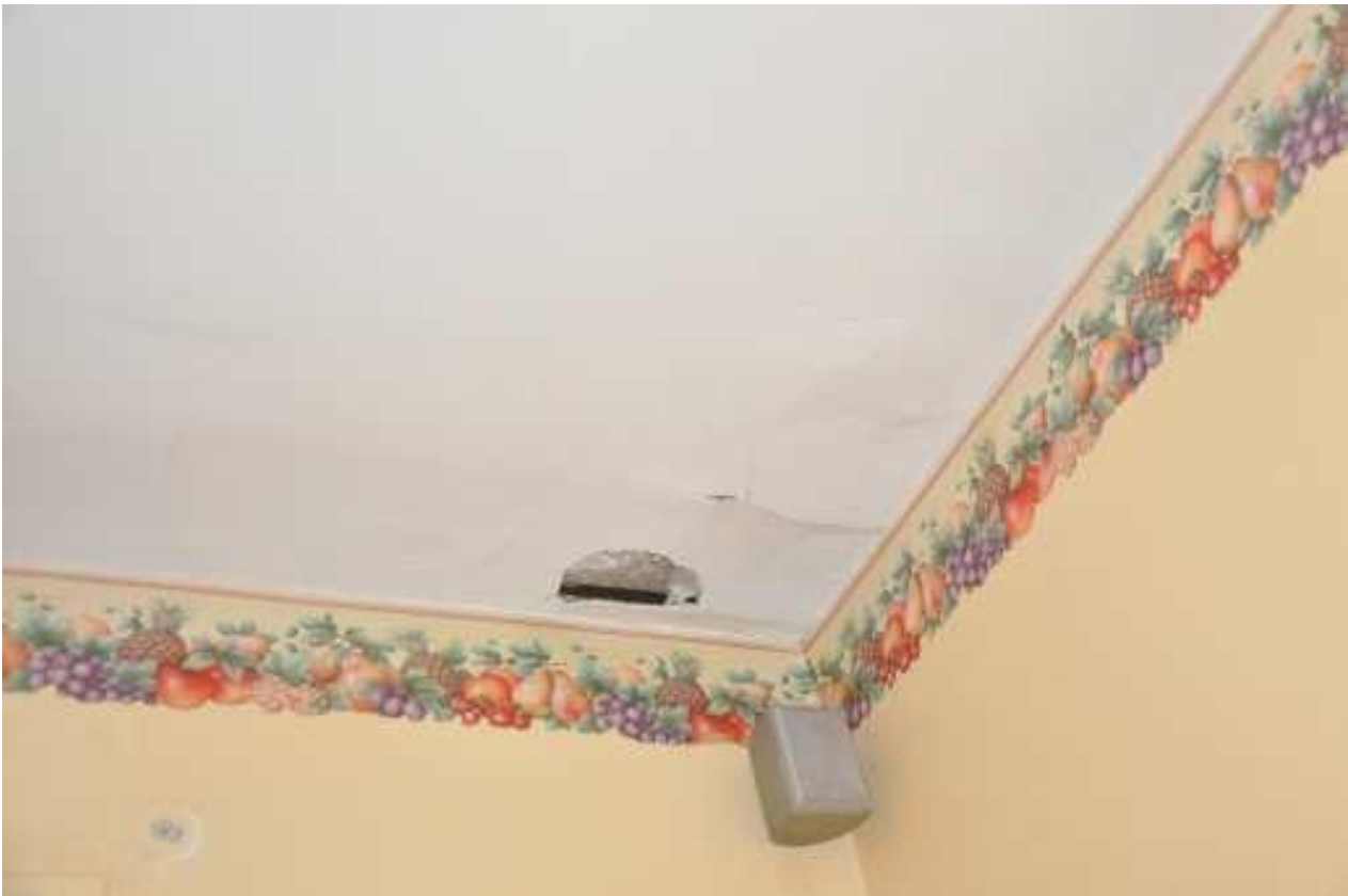
Foto 34 - Stanza 2 - Degrado del soffitto
