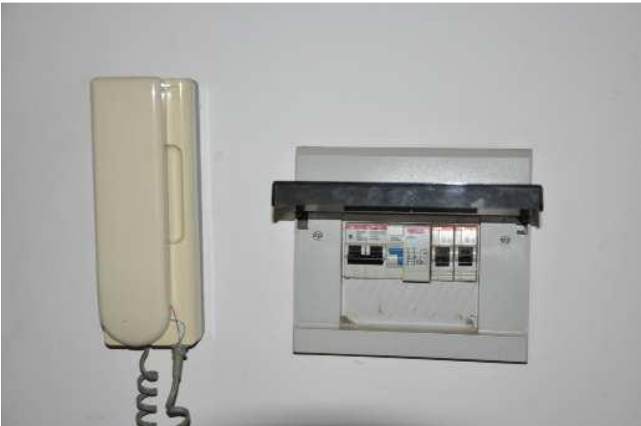
Foto 32 - Particolare impianto elettrico e citofonico
