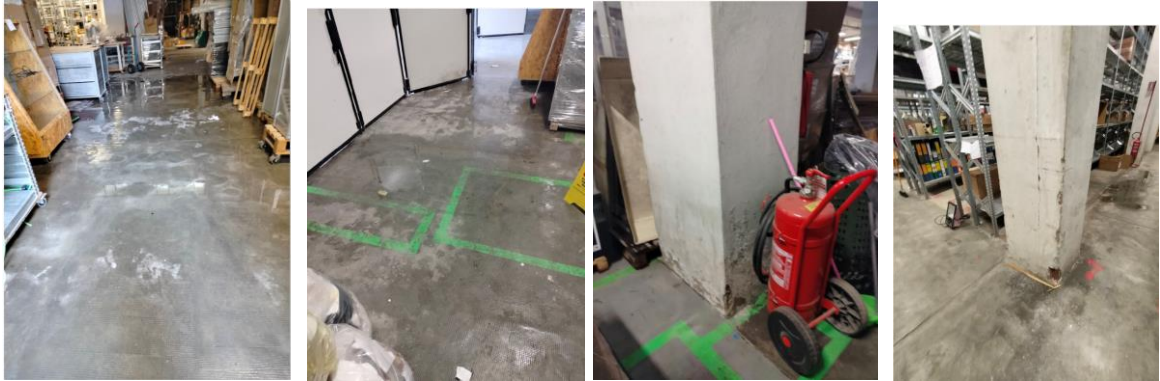
Infiltrazione d'acqua dal basso nel pavimento del magazzino
