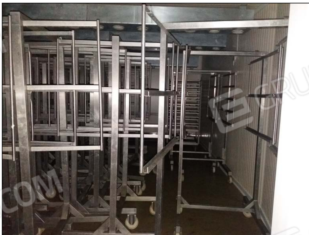
Foto n. 35: prospettiva ingresso cella frigorifera “celfr8”- unità “U1”
