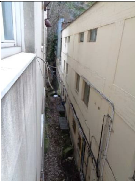
Vista distacco laterale a sud
