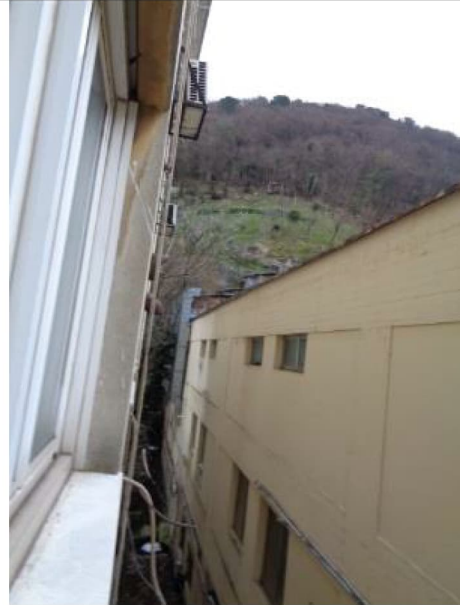
Vista distacco laterale a sud
