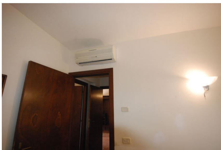
Foto 18 Climatizzatore della seconda camera
