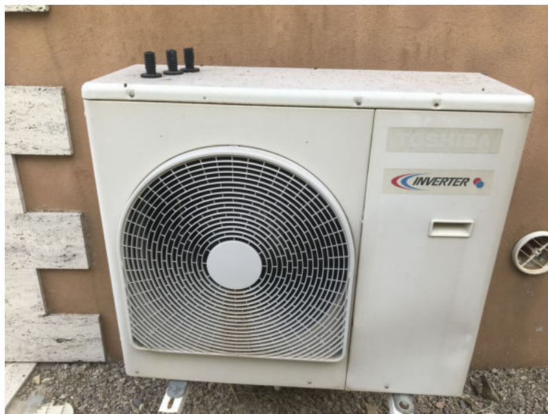
Foto 22 Unità esterna per climatizzazione
