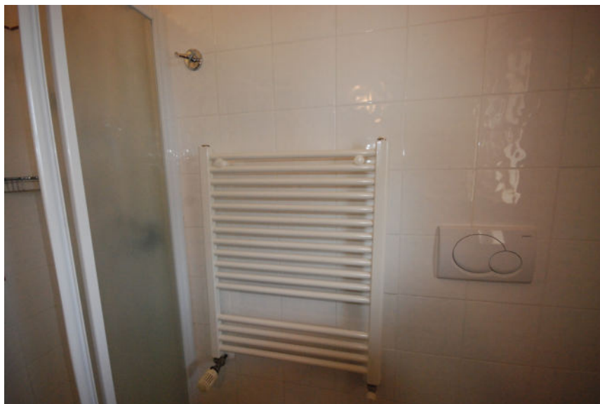
Foto 19 Il termo-arredo di un bagno
