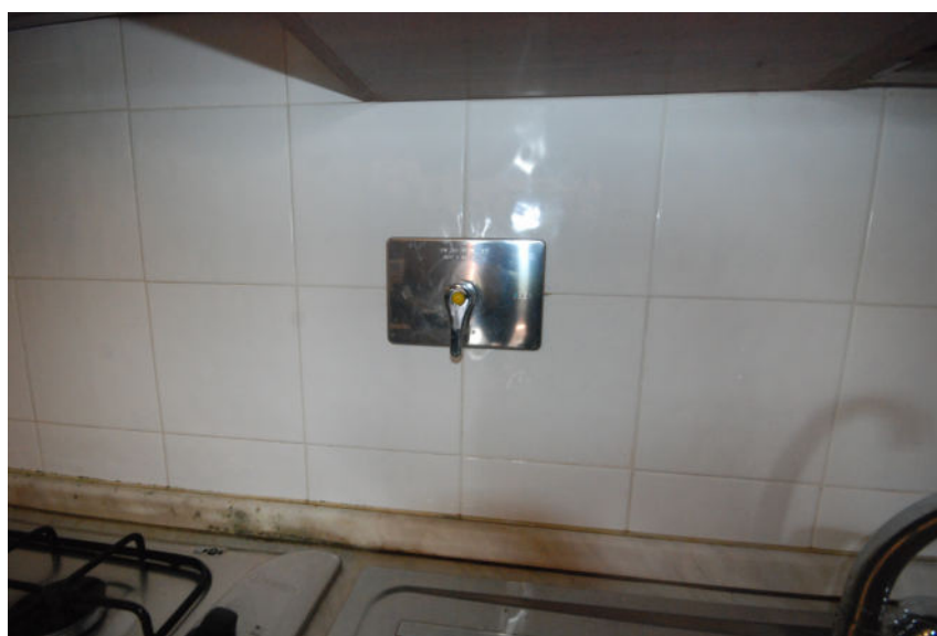
Foto 15 Interruttore del gas dei fuochi del piano cottura
