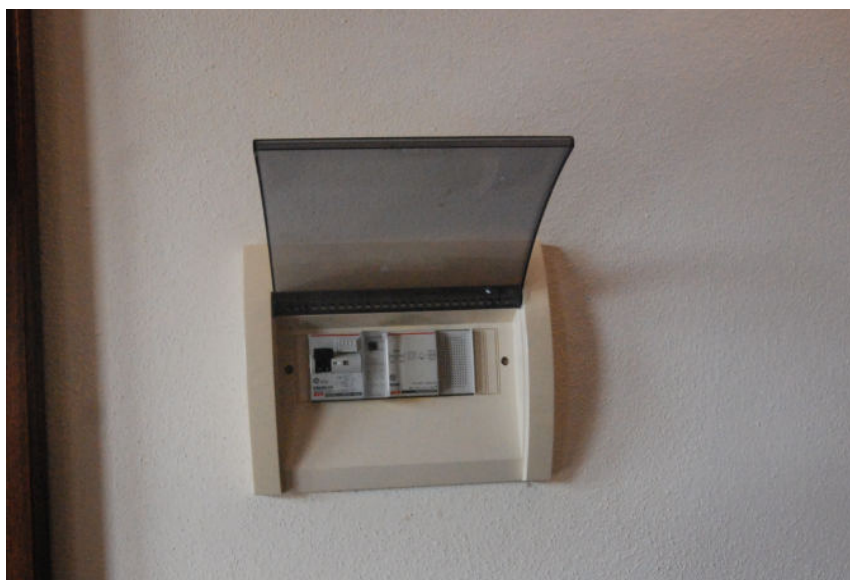
Foto 14 Quadro impianto elettrico
