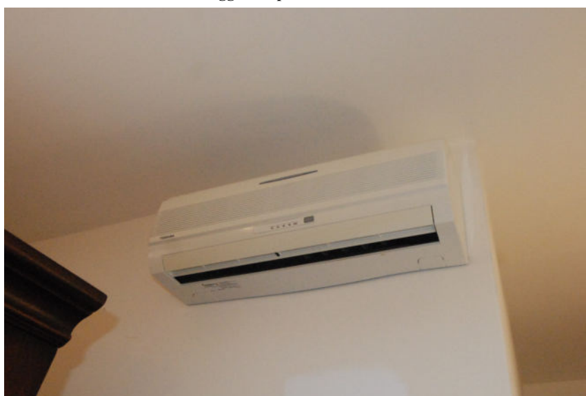
Foto 17 Climatizzatore della camera con bagno
