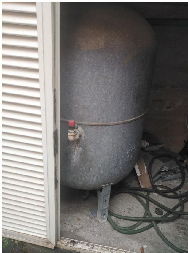
Foto 7 – IMPIANTO AUTOCLAVE COMUNE.
