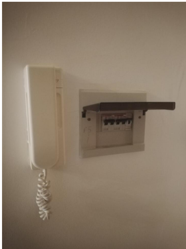
Foto 33 – SUB.15: CITOFRONO E QUADRO ELETTRICO.
