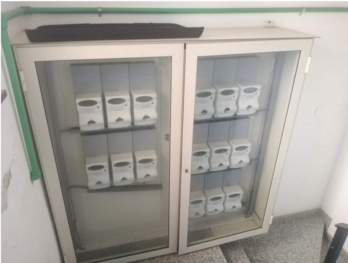
Foto 13 – ARMADIO CONTATORI S.E.L. RICAVATO NEL VANO SCALA “A-A1”.
