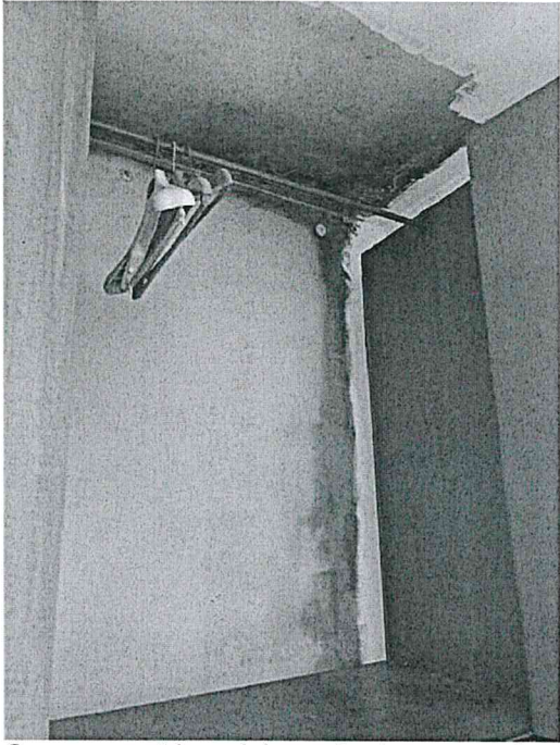
Camera matrimoniale particolare ammaloramento angolo verso l'esterno
