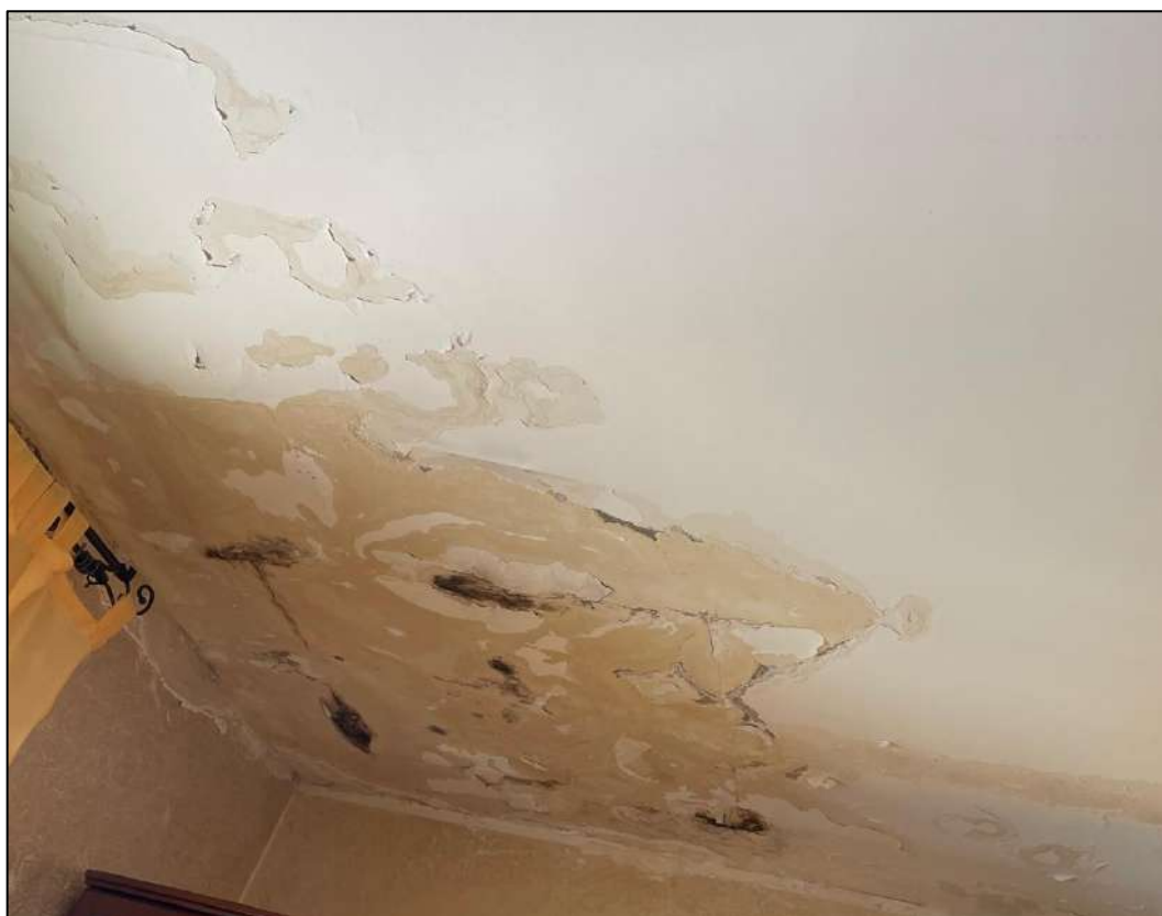
2.4. Particolare degrado per infiltrazione nella porzione di soffitto del vano Cucina
