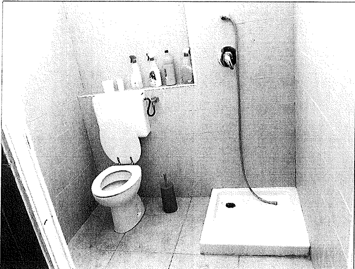
FOTO N° 14 Opificio - Piano Terra - wc
