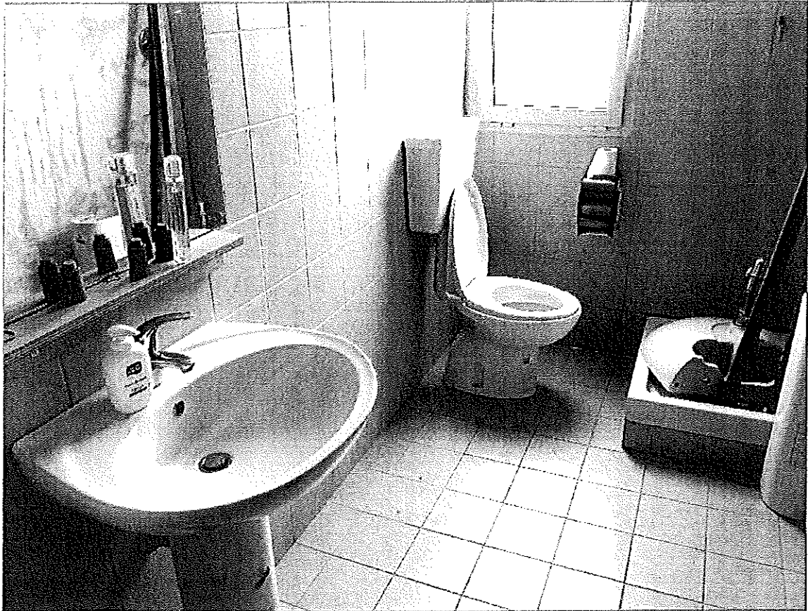
FOTO N° 21 Opificio -Piano Primo - servizio igienico - lavabo non installato
