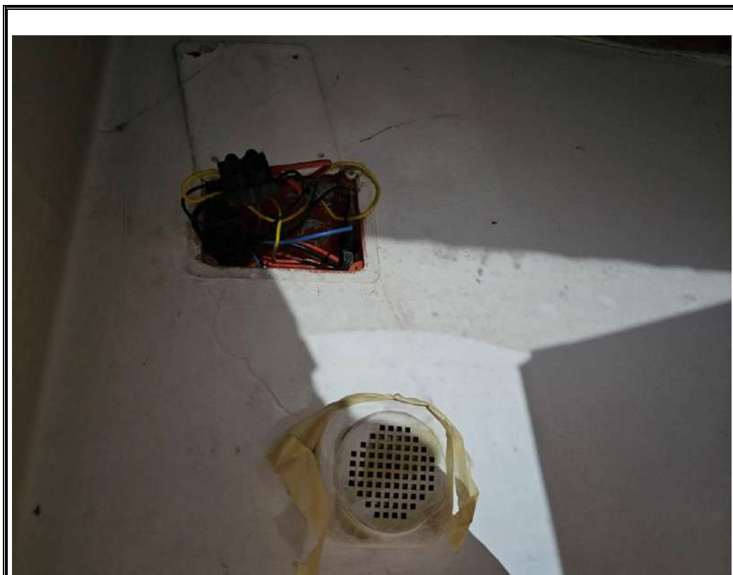
Foto n. 18 Particolare dell'impianto elettrico.
