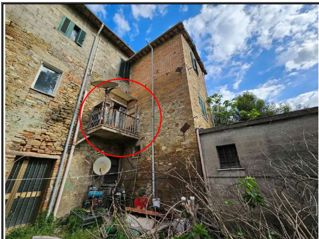
Foto n. 5 Vista del retro della palazzina con cerchiati in rosso il balcone e la porta finestra di accesso, non rappresentati nella planimetria catastale.
