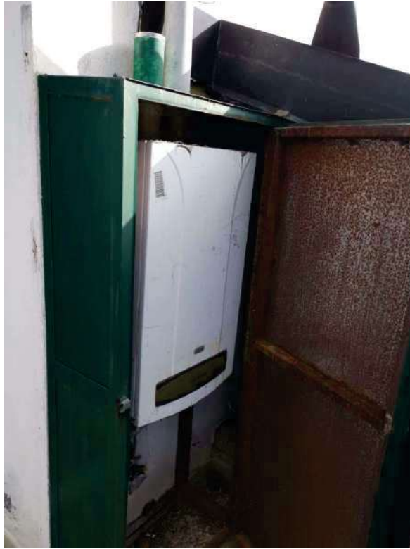
Foto 13 – Vista caldaia termica a gas metano
