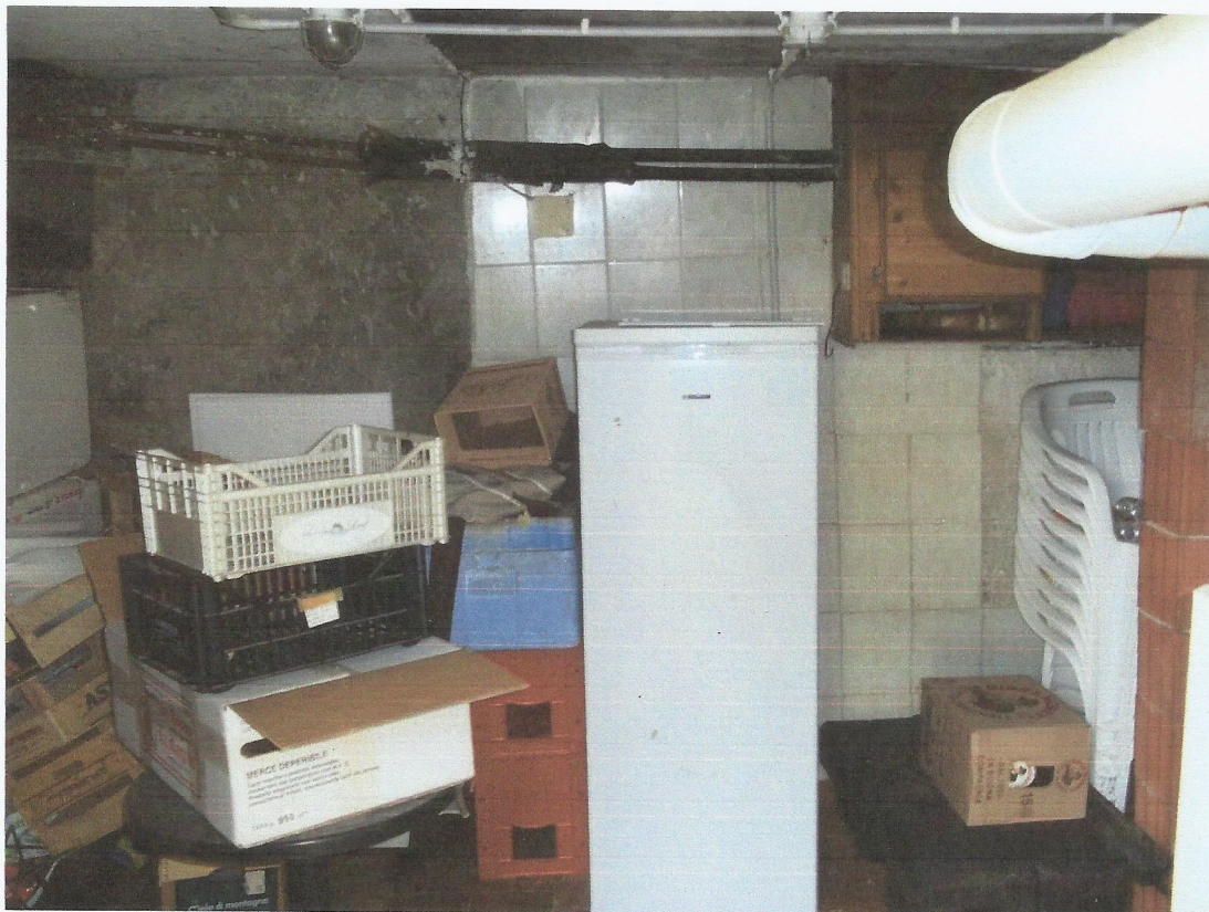
VISTA LOCALE CALDAIA PIANO SEMINTERRATO
