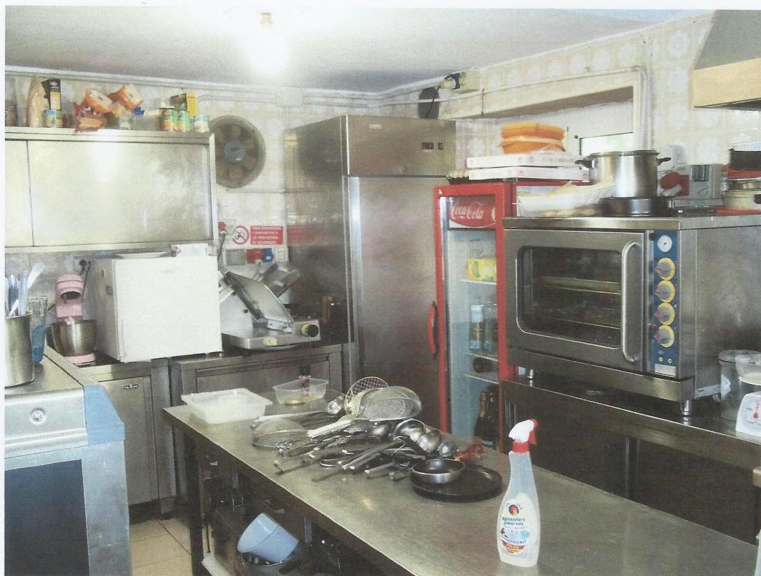
VISTA CUCINA RISTORANTE PIANO TERRENO
