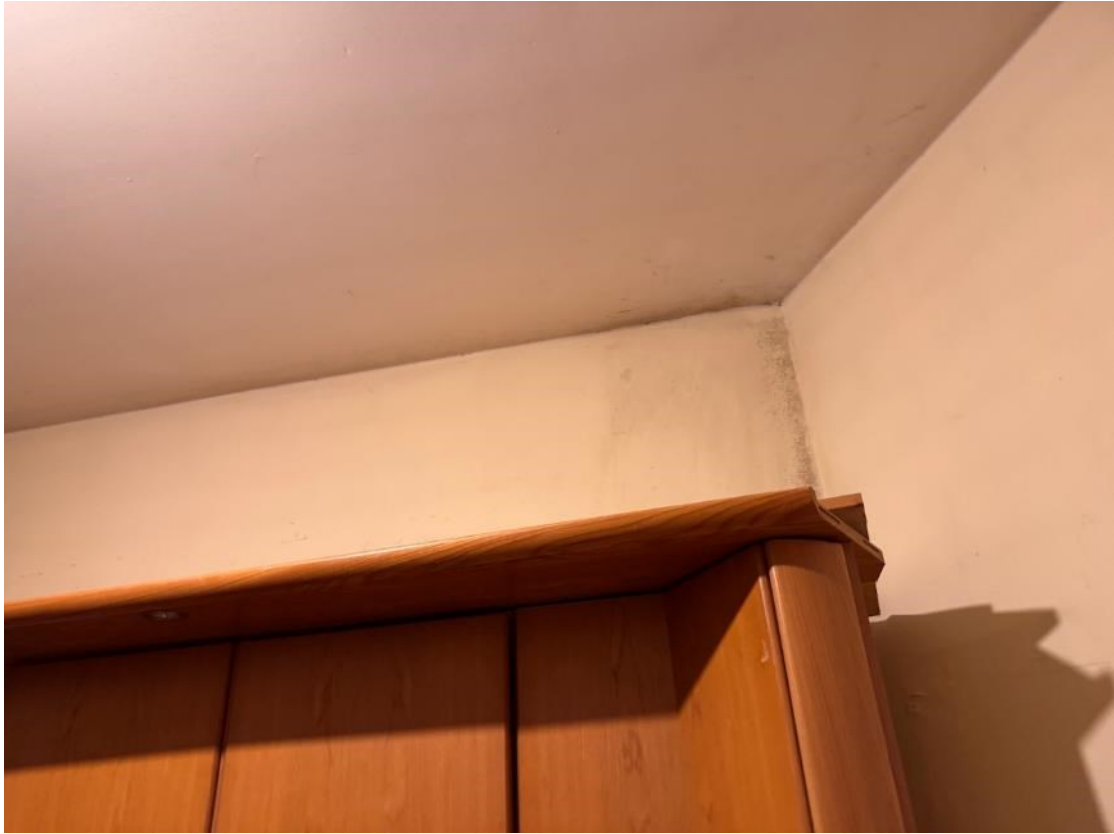
Camera da Letto 2 – particolare (muffa)
