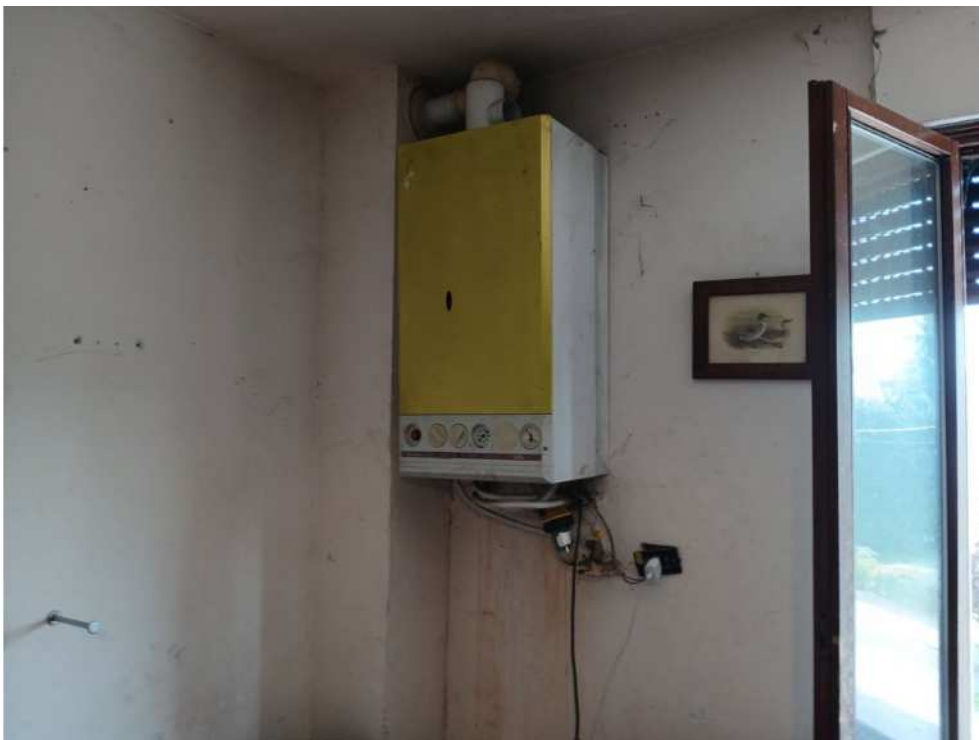
Zona giorno – particolare caldaia
