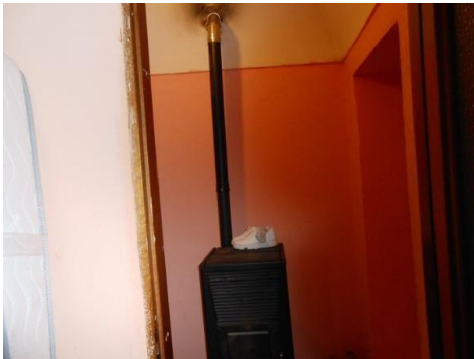
Figura 26 – particolare del riscaldamento
