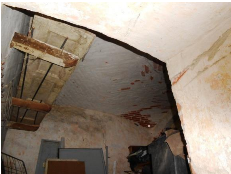
Figura 23 – Cantina: pareti e soffitto
