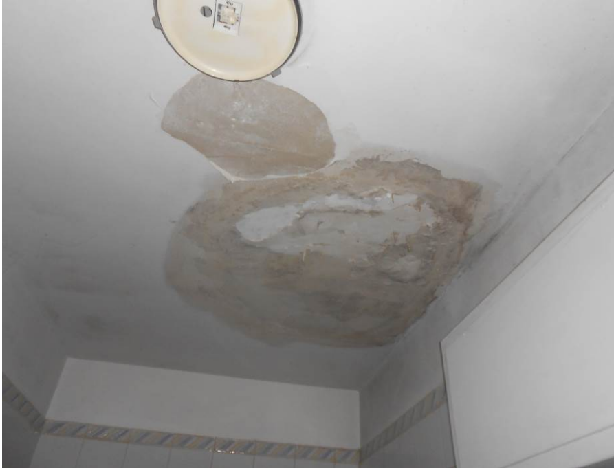
(g) Fotografie dell'abitazione a piano rialzato: salotto (a); cucina (b); ripostiglio (c); bagni (d); corridoio (e); camere (f); rivestimenti danneggiati da fenomeni di umidità (g).
