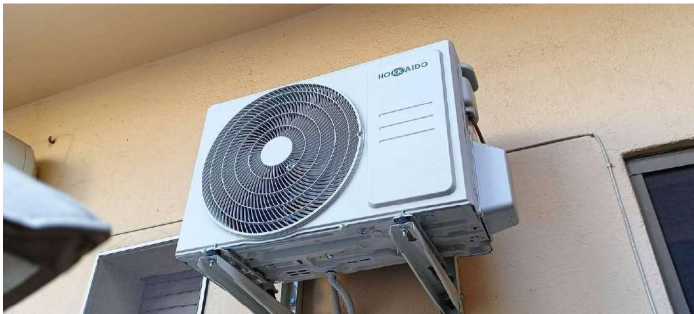
FOTO 15. Unità trattamento aria
