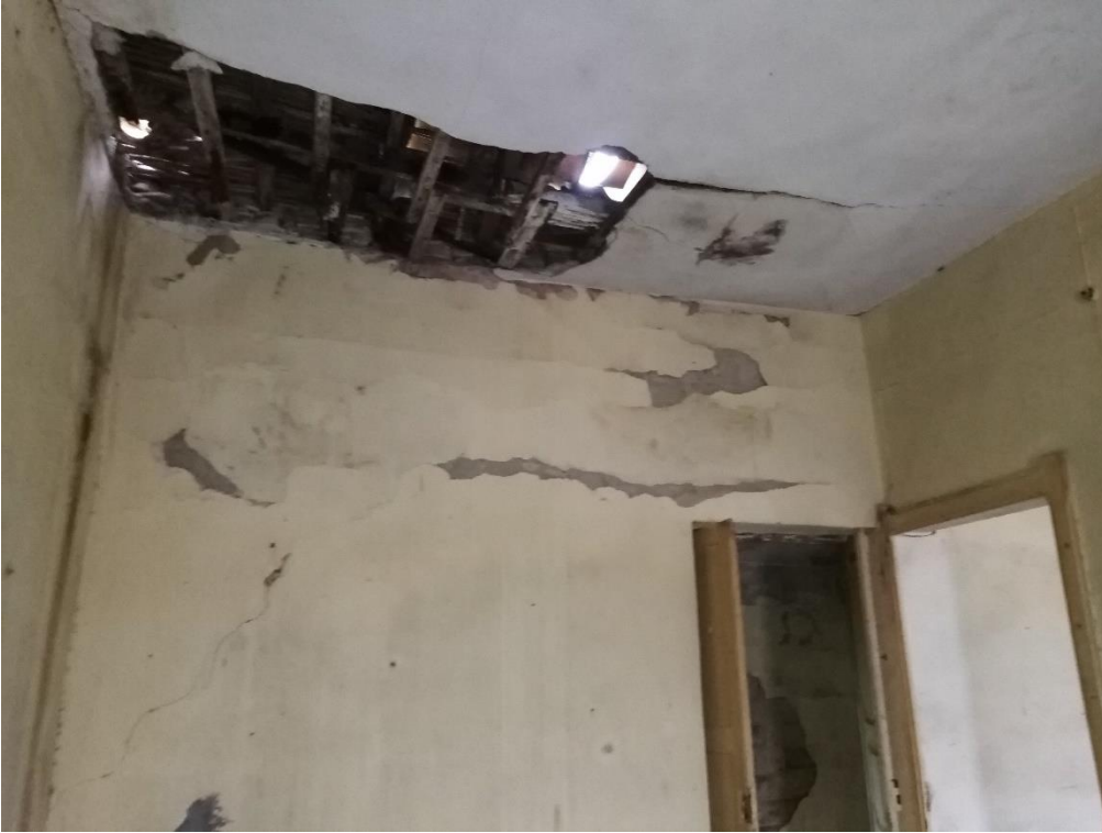
foto 11 - soffitto piano primo
