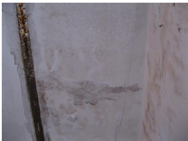
Foto 26 - Soffitto e pareti camera 2
