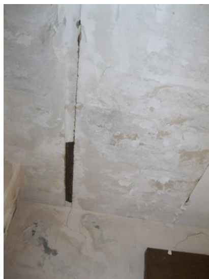
Foto 21 - Soffitto e pareti camera 1
