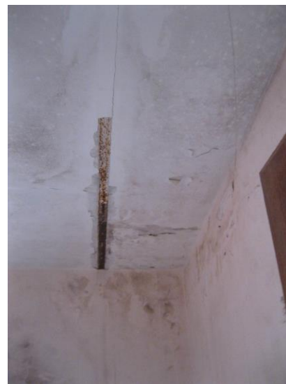
Foto 25 - Soffitto e pareti camera 2
