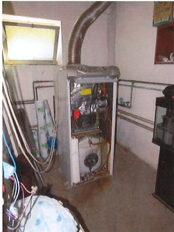
vista del locale tecnico in comune
