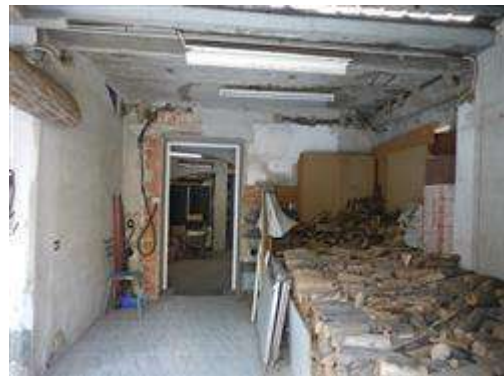
Vista ingresso al locale
