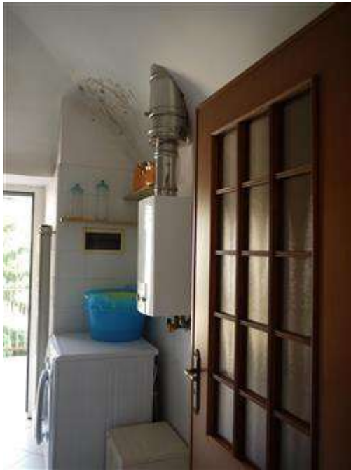
LOCALE CUCINA CON EVIDENTI TRACCE DI INFILTRAZIONE
