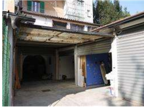
Vista varco di ingresso ai locali corpo B dalla porzione di corte mappale 768
