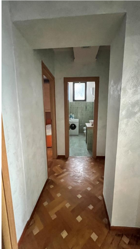
Foto 9 – Disimpegno nell’area “abusiva”
